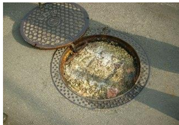
油脂類の堆積により閉塞したマンホール(静岡)
